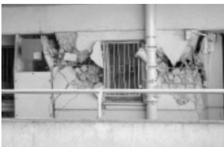
全世帯が退居した11階建て市営住宅の損壊
