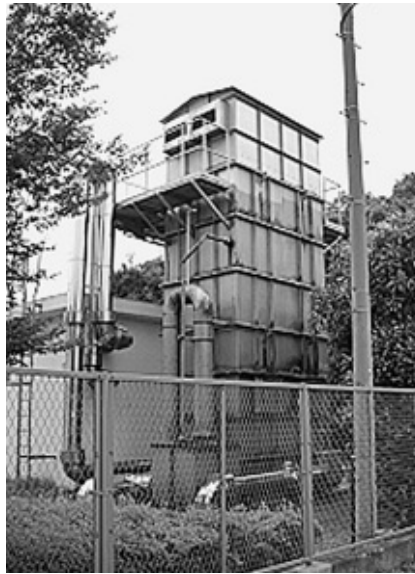
田口浄水場の有害物質の除去装置
